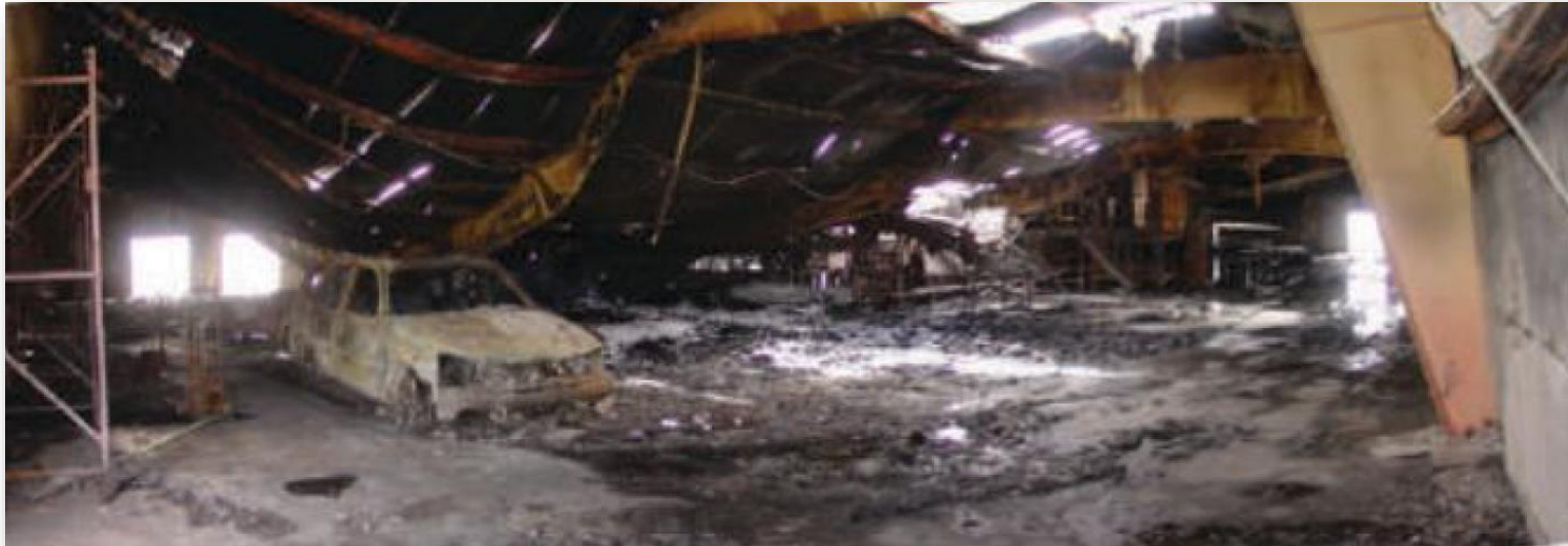
FIGURA 6.3.15.3 Vigas de acero I deformadas por calor baja carga.
