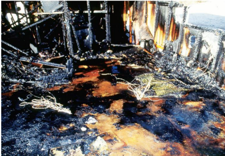
FIGURA 6.3.20.7.3(a) Marcas de quemado irregular en el suelo de una habitación incendiada durante una prueba en la que se utilizaron líquidos no inflamables.
