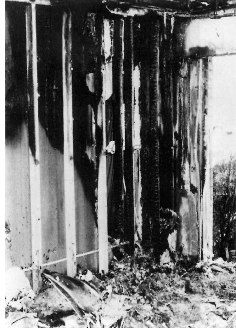
FIGURA 6.3.20.1.1 (b) Marca en V con Daños en Pared y en Vigas de Madera.
