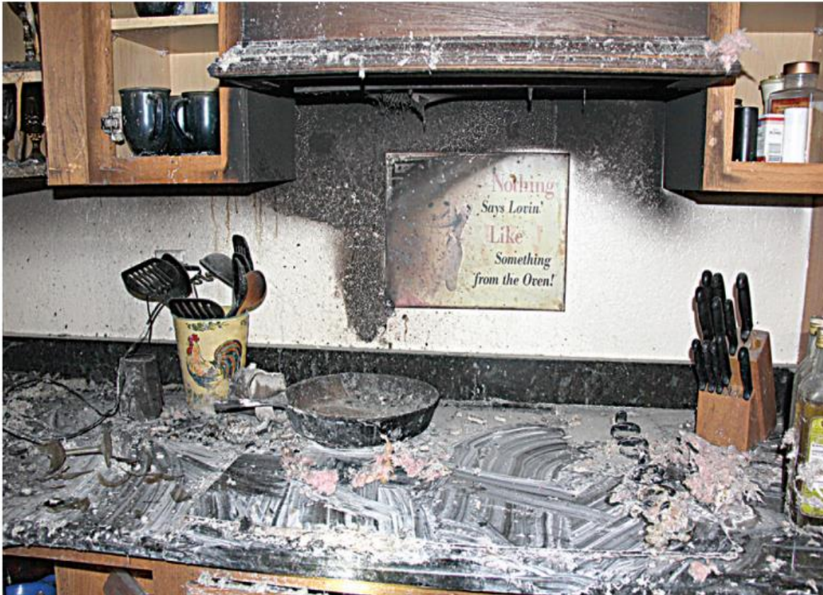
FIGURA 6.3.20.1.1 (c) Marca en "V" en un muro situado sobre una estufa.
