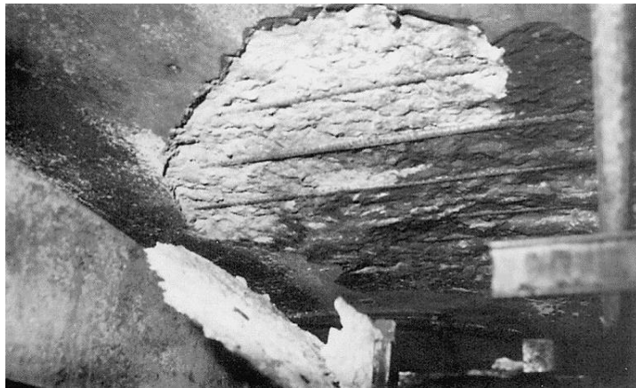
FIGURA 6.3.14.3.3 Exfoliado en un Techo.
